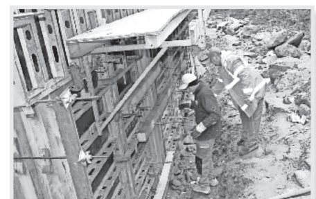
Endlich! Die Landesstraße L 148 durch das Wehrtal wird nach fast 3-monatiger Sperrung wieder für den Verkehr freigegeben.
